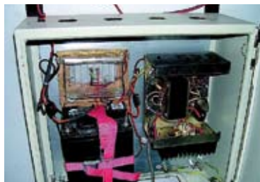
Deze noodvoorziening is wel heel erg provisorisch aangebracht.
