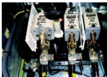
Verschillende typen smeltpatronen zijn door elkaar gebruikt. Die van fase L1 past niet goed in zijn houder.
